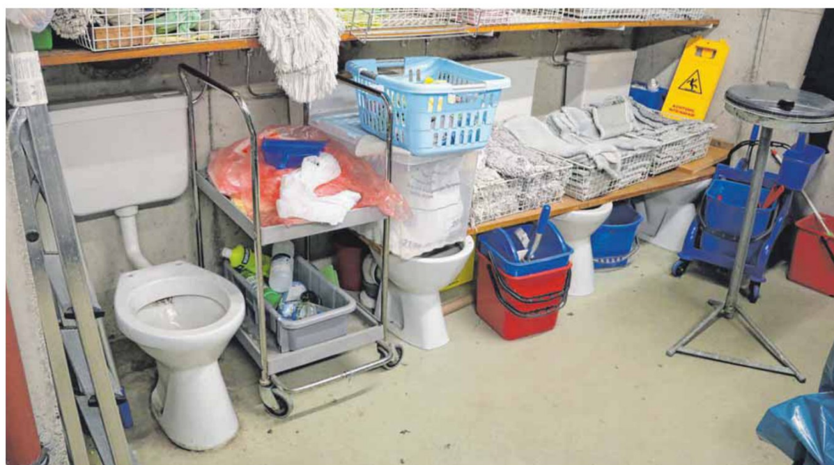
Die Toilettenanlage im Schutzbunker unter Haus D: Für Intimsphäre war im Kriegsfall wenig Raum. Inzwischen wird der Raum als Lagerfläche für Putzmaterialien genutzt, die Toiletten sind aber noch funktionsfähig.
