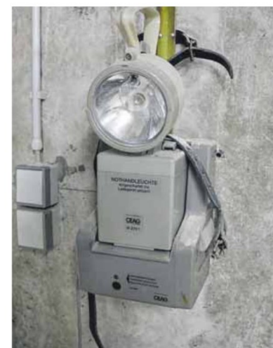
„Nothandleuchte“ neben einer Tür.
